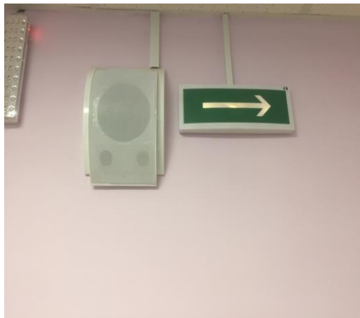
Визуальные средства путей эвакуации
